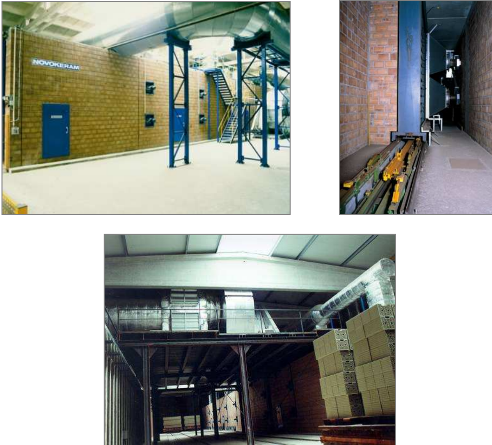
Fig. 2.6.3-c Vista exterior de cámara de secado, unidad de ventilación lateral y ventilador de aire caliente central, con cámara de mezcla y conexión a horno.
