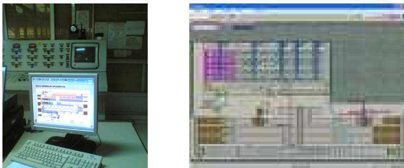
Figura 2.7.3-b Sistema de control de temperaturas de un horno túnel.
