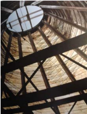
Casa Waldman , Peter Waldman, Virginia, EEUU, 1996. (p. 486) Dentro de una arquitectura de tendencia orgánica se presenta un lucernario cónico irregular con claro objetivo simbólico-estético y lumínico muy teatral, ya que está construido con tejido translúcido que emana una difusa luz amarillenta sobre una compleja estructura de diversos materiales. [📷] Asensio (2006: 492-3).
