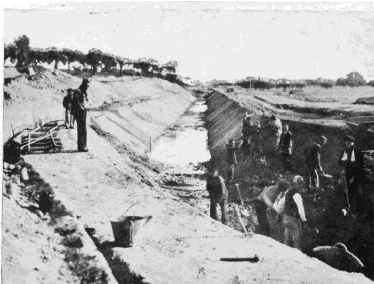
Fig. 9 Otra de las imágenes que nos muestra el trabajo de los presos en el canal. Se observa el trabajo a pico y pala.
