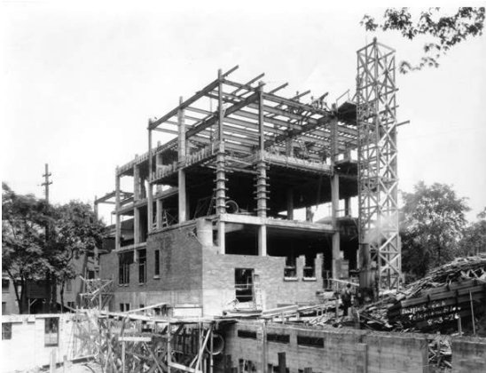
Figura 2.36: Battle Creek, Michigan, 1926. Montaje de la estructura metálica en una pequeña central. Fuente: Willard Library
