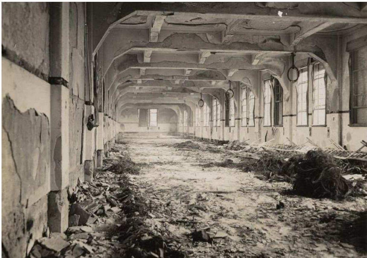
Figura 5.3: Ruinas de la central de Hiroshima (Japón). Esta foto fue tomada por el Cuerpo de Ingenieros del Ejército de Estados Unidos y formaba parte de un informe secreto sobre los efectos de la bomba atómica en las infraestructuras públicas 5 . Ha vuelto a ver la luz en una exposición del International Center of Photography de Nueva York 6 . En esta sala, posiblemente de operadoras por los grandes ventanales, el equipo se ha evaporado pero la estructura ha resistido relativamente bien. Fuente: EL PAÍS/ICP .
