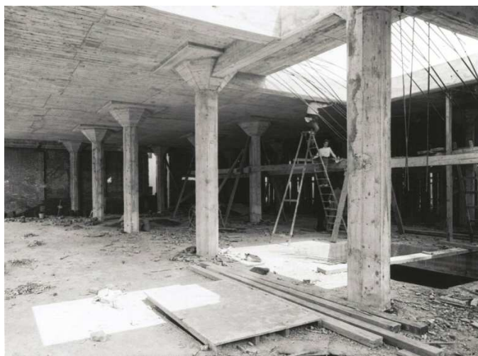
Figura 4.107: En esta fotografía de Claret, de 1927, se ve la estructura de hormigón en las obras de la central de Clot. Archivo Histórico Fotográfico de Telefónica.
