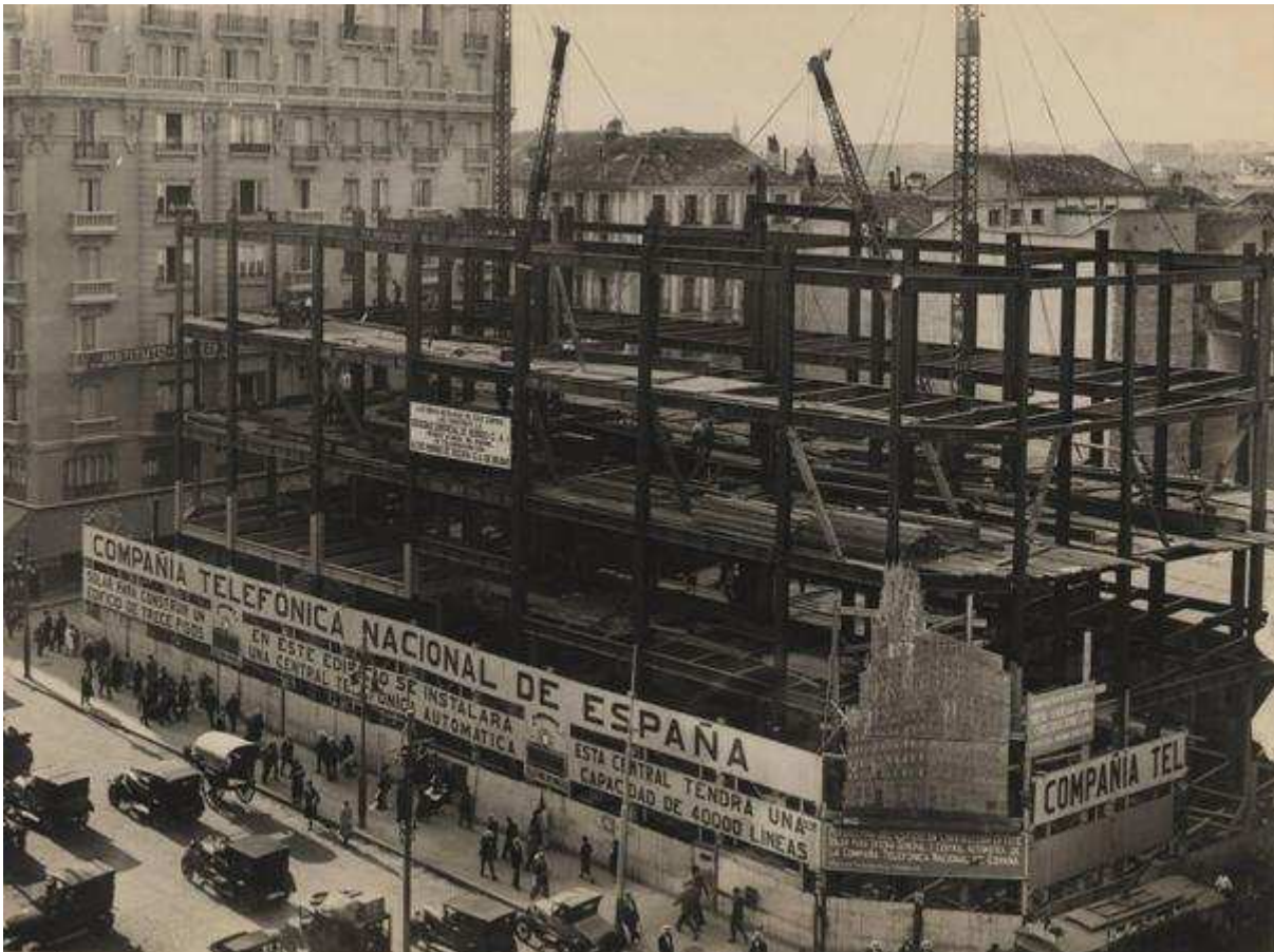
Figura 1.1: El edificio anuncio. Esta imagen, tomada por Alfonso dentro de una serie concebida con fines publicitarios, muestra la sede de Gran Vía en construcción. La valla anuncia la nueva compañía, la maravilla tecnológica que se está construyendo y la imagen final del edificio. La idea se atribuye a Kenneth McKim, primer director de publicidad de la CTNE. Archivo Histórico Fotográfico de Telefónica.
