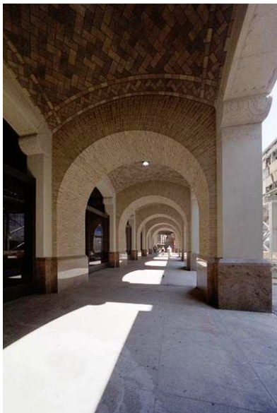
Figura 3.68: Galería de la calle Vesey. Fuente: Verizon.
