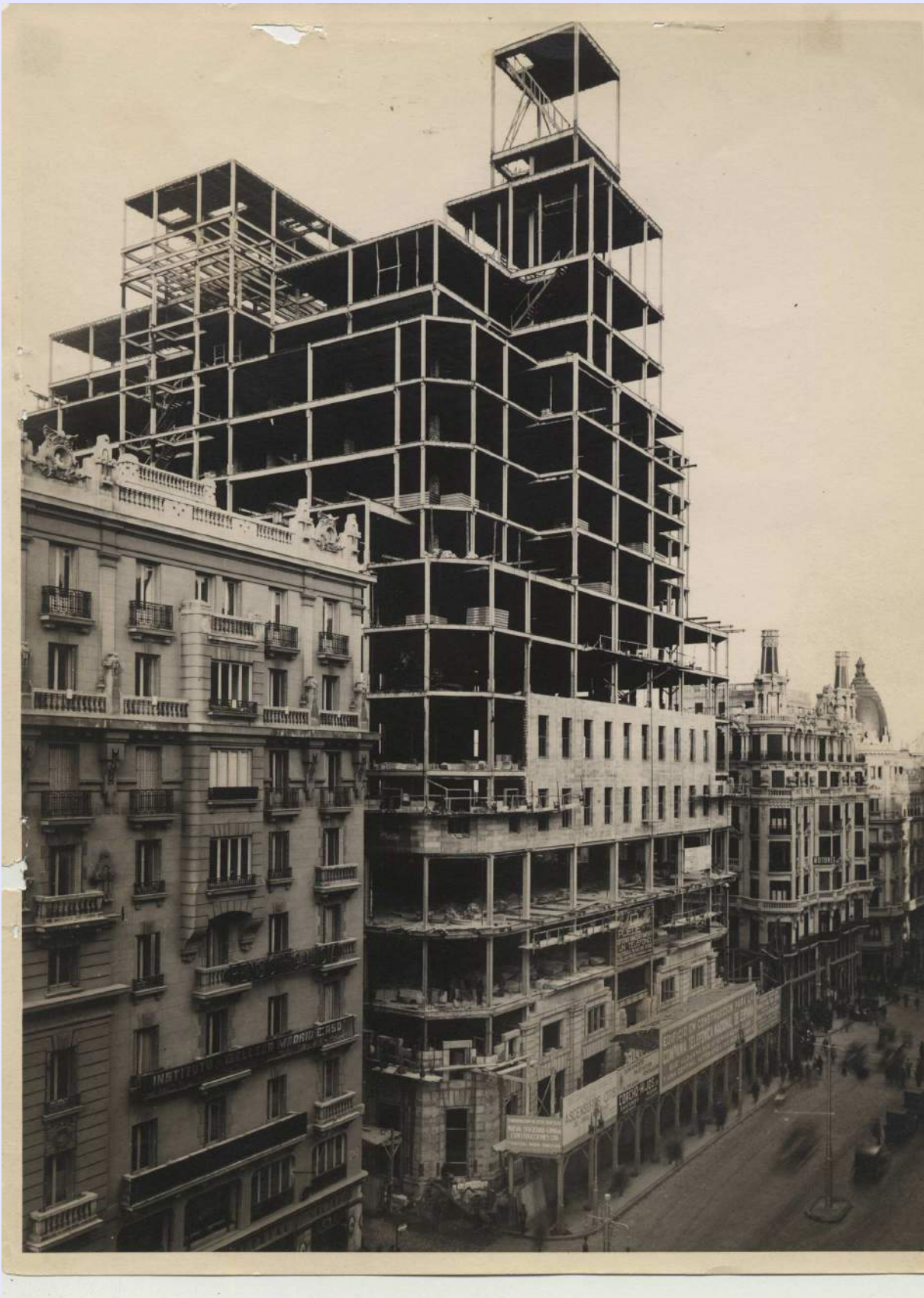
"Como floración que el sol del verano alienta y fecunda, el edificio de la Telefónica se adorna todos los días con un nuevo piso de ramaje de hierro, apareciendo esa gran araucaria japonesa que es como un esqueleto de pagoda en construcción moderna. Los que han salido en el ómnibus del '¡Adiós Madrid, que te quedas sin gente!', cuando vuelven se encuentran con varios rascacielos, nidos de máquinas de escribir, atalayadores del negocio, archivadores automáticos del mundo". Ramón Gomez de la Serna. "Elucidario de Madrid", 1931. Fotografía de Alfonso, enero de 1928, Archivo Histórico Fotográfico de Telefónica.
