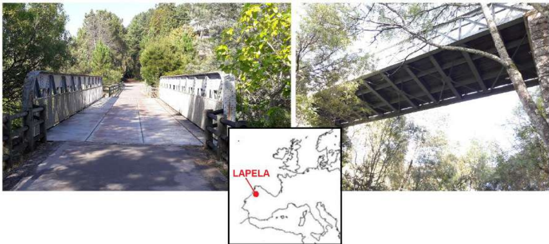
Figura 6.33 Puente de acero histórico del río Gadanha. a) Foto del interior de la estructura. b) mapa de ubicación del puente. c) Foto inferior del puente férreo del río Gadanha.
