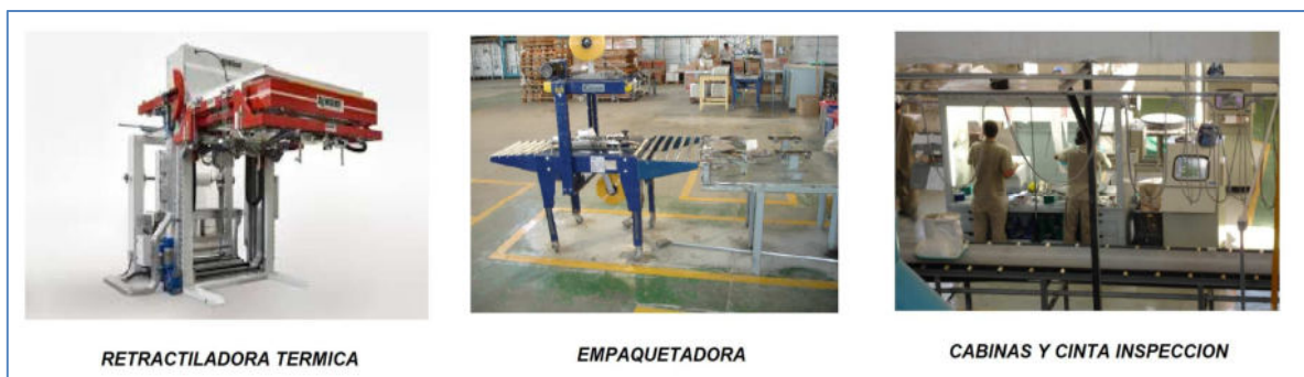
Figura 21. Equipos sección de control final. Fuente: (Elaboración propia).
