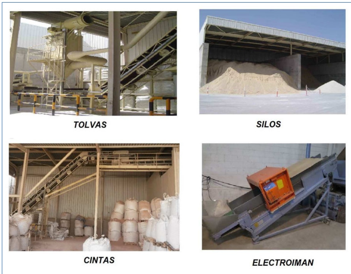
Figura 11. Equipos de la sección de primeras materias. Fuente: (Elaboración propia)
