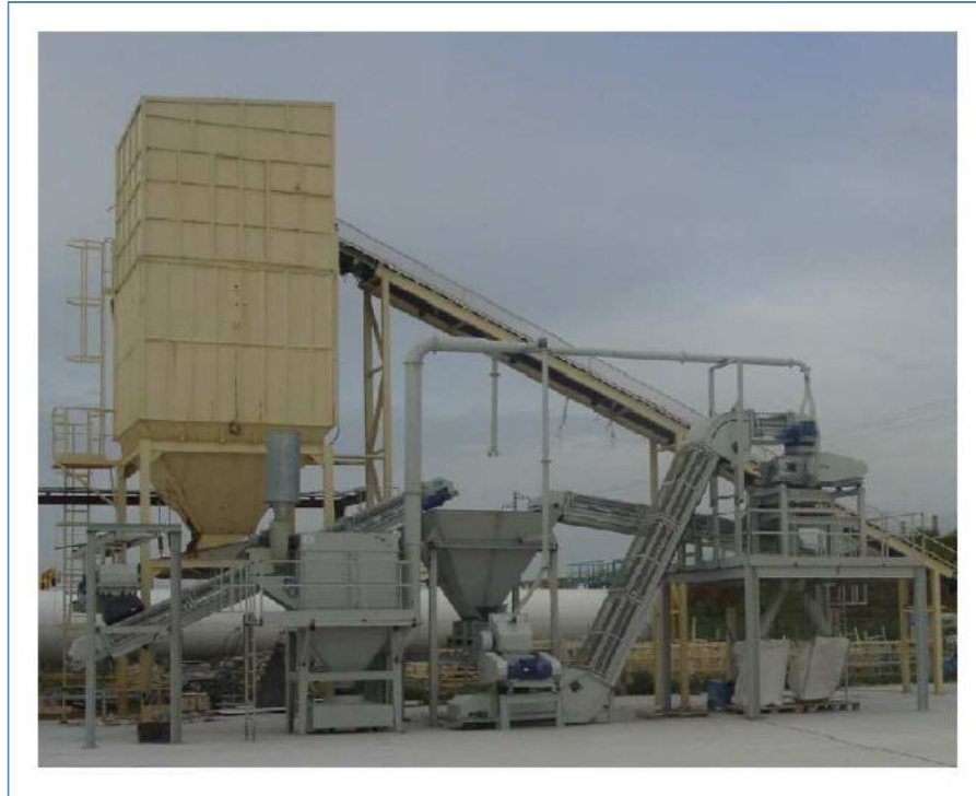
Figura 22. Conjunto tolva de pérdidas con machacadora. Fuente: (Elaboración propia)
