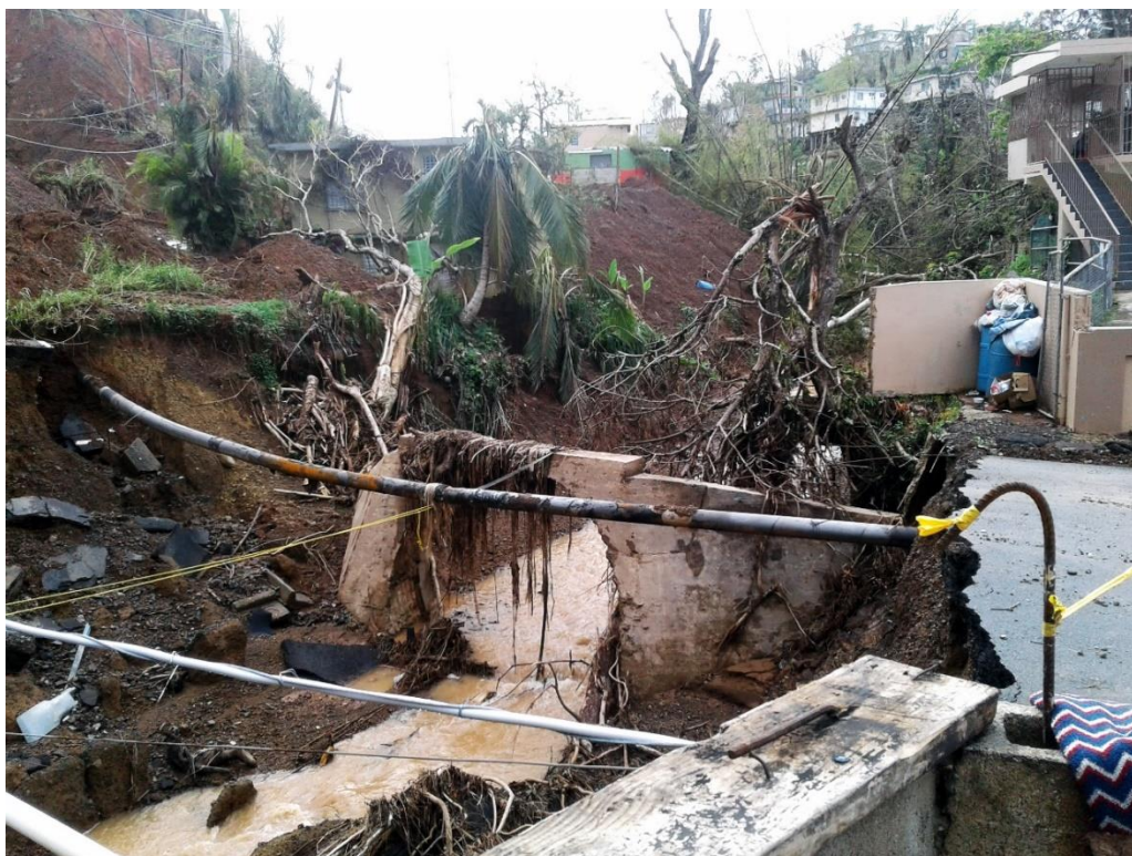
Foto 19. Derrumbe de la carretera PR-152 en el Poblado de Barranquitas. Puerto Rico, 24 de septiembre 2017.
