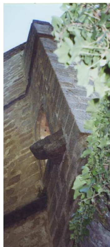
Vano para el paso del contrafuerte del lado sur y ménsula para soportar el piso de la galería.
