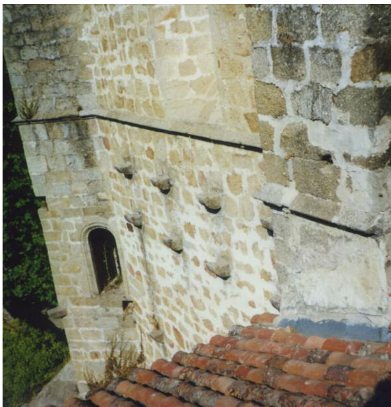
Lateral sur de la nave de la iglesia. Machones y ménsulas para soportar las vigas corridas de apoyo de la galería. Los inferiores para el piso volado y las dos filas superiores para el tejadillo.
