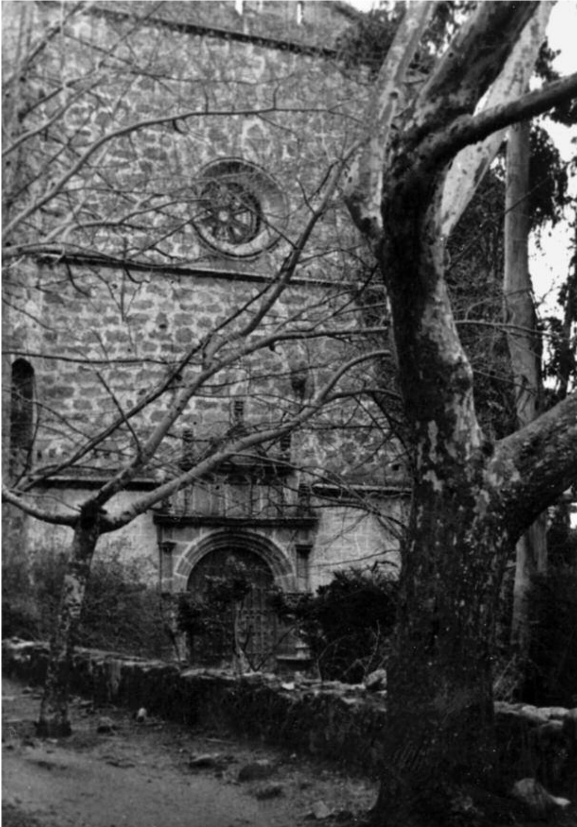
Fachada de la Iglesia. Andre Conte 1935. El cuerpo inferior conserva un revoco con despiece de sillares. Junto al vano del contrafuerte izquierdo se ven, alineadas, las cabezas del forjado del piso de la galería.
