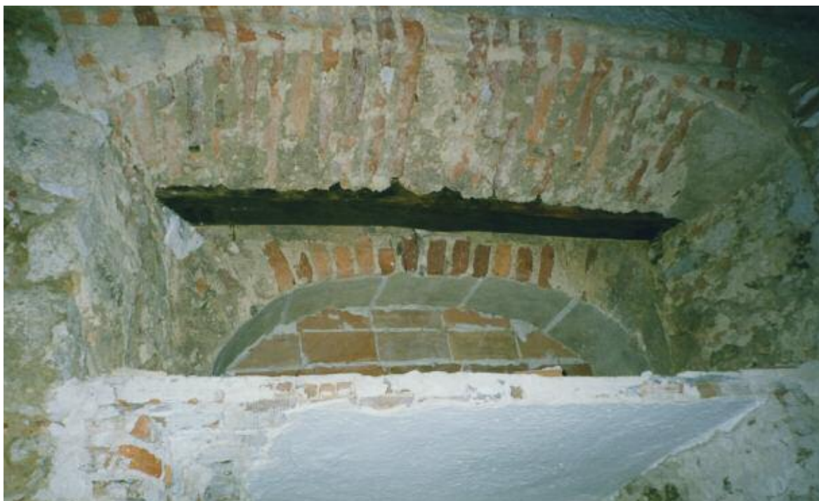
Hueco de la puerta que pudo servir de paso al primer refectorio y que quedó cegada tras la intervención de González-Valcarcel. Vista desde el interior. En el durmiente de madera se conserva el hueco para albergar el quicio de una puerta de madera. El arco interior está enmarcado por un alfiz labrado en ladrillo.
