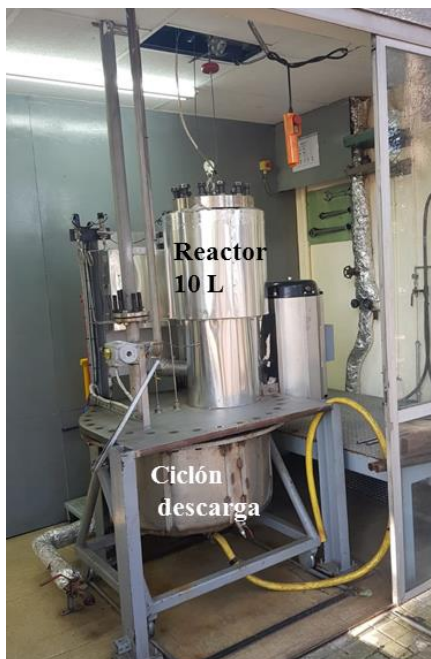
Figura 3.1. Unidad piloto de explosión por vapor en las instalaciones del CIEMAT
