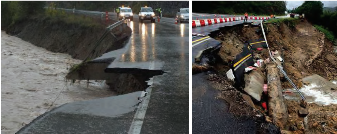
Figura 65 Socavamiento de carreteras
