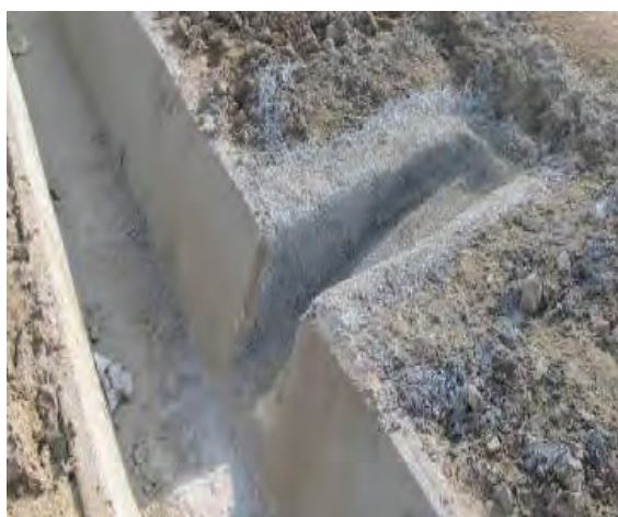
Figura 114 Rampa de escape para fauna en cuneta
