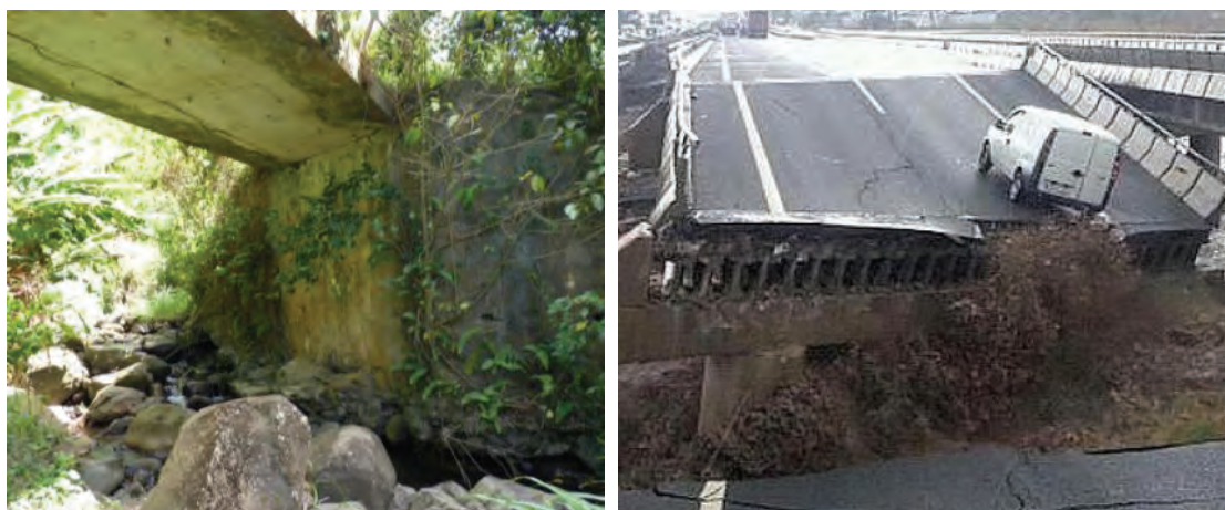
Figura 63 Erosión en cimientos y colapso de estructuras
