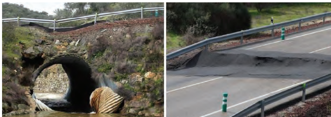
Figura 64 Hundimiento en una carretera
