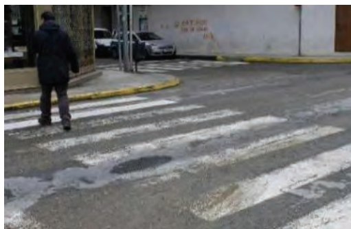
Figura 83 Paso de cebra en mal estado
