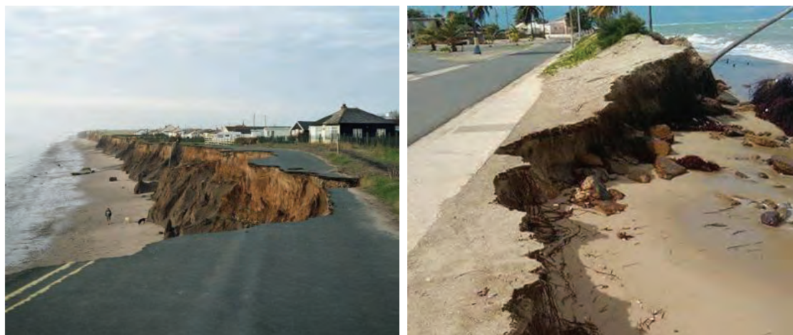
Figura 77 Carreteras afectadas por erosión costera
