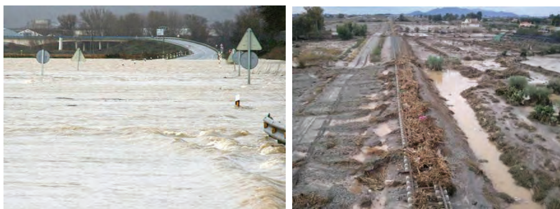
Figura 61 Daños por inundaciones en infraestructuras lineales de transporte
