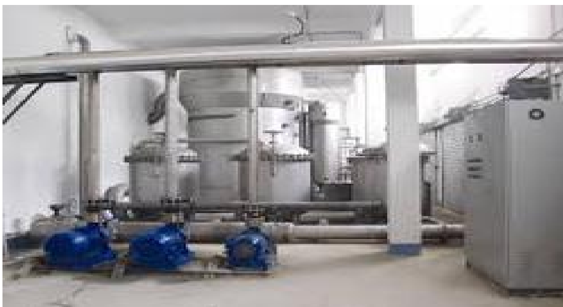
Fig.4.59 (b). Planta de producción de agua purificada (PW). Fuente : Nilsan Nishotech, 2016.
