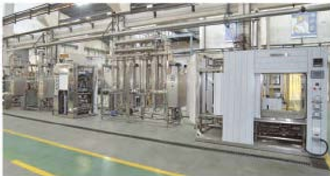
Fig.4.52. Destilador multiefecto y planta de Agua para Inyección (WFI). Fuente: Pharmalab (2015) http://www.pharmalab.com/media/pdf/Water%20for%20Injection%20Generation%20Plant%20Brochure.pdf
