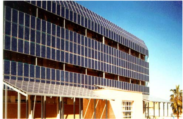
Figura 3. Sistema fotovoltaico conectado a red en fachada y pérgola en edificio aulario del campus de la Universidad de Jaén
