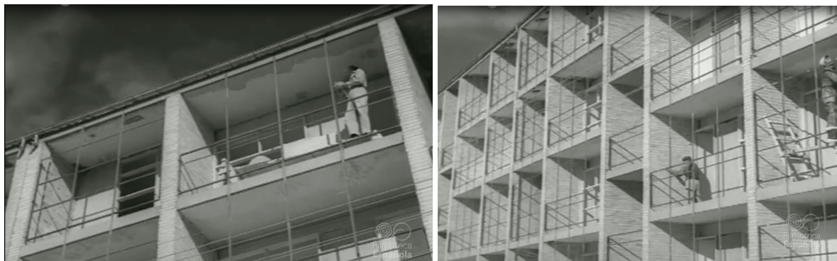
Fig. 21 y 22. Exteriores de algunas de las viviendas en proceso de construcción del documental “Sesenta mil viviendas. Plan de Urgencia Social de Madrid”. Fuente: NO-DO
