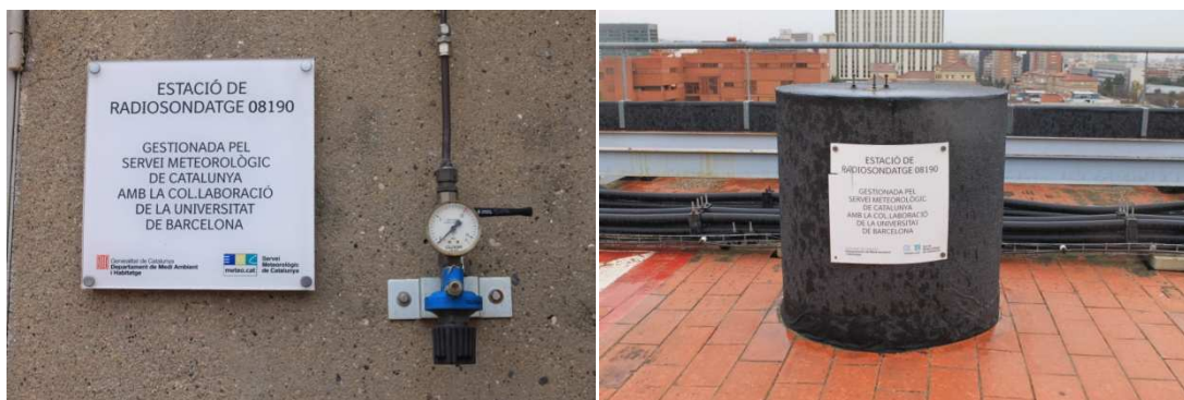
Figura 3. Estación de Radiosondeo Manual, operativa desde el año 1998 hasta el 2012. Fotografías propias tomadas el día 09/03/2016.
